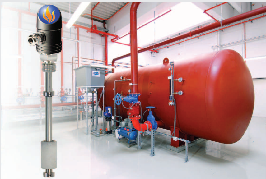
Wassertank-Füllstandsüberwachung mit dem kundenspezifischen Füllstandssensor MELS-F für die CALANBAU Brandschutzanlagen GmbH.
